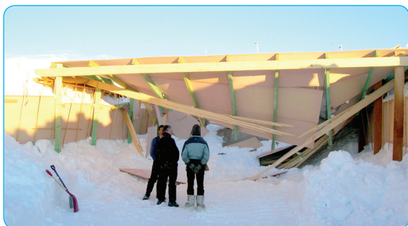
Figuur 19: Het ingestort dak van de garage
